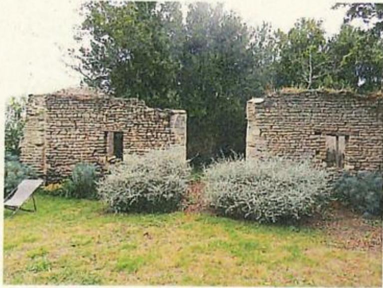
Anciennes écuries et toit aux moutons, en ruines. Phot. Agathe Aoustin IVR75_20201703913NUCA
